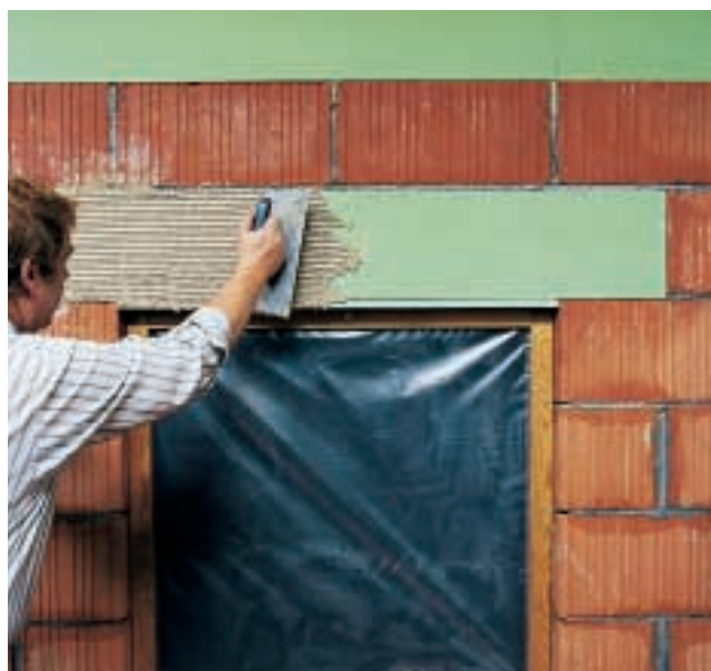
Рис. 22. Оконная перемычка в теплоизолируемой кладке. Горизонтальное коробление крепежного моста, фиксирующего штукатурку.
