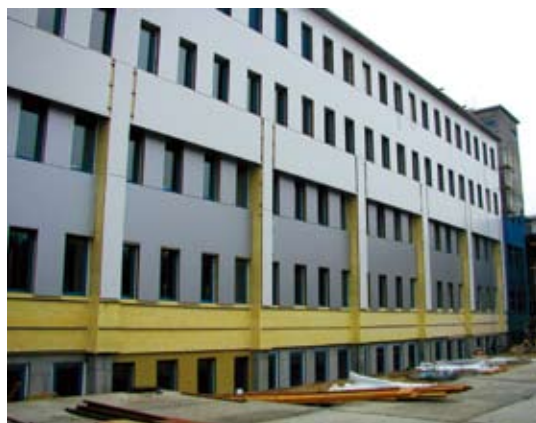
В конструкции вентиляруемого фасада использовалось двухслойное теплоизоляционное решение ISOVER KL 37 + ISOVER RKL.
