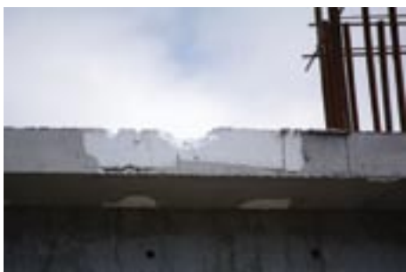
Фото 3. Разрушение обычного пенопласта; г. Санкт-Петербург
